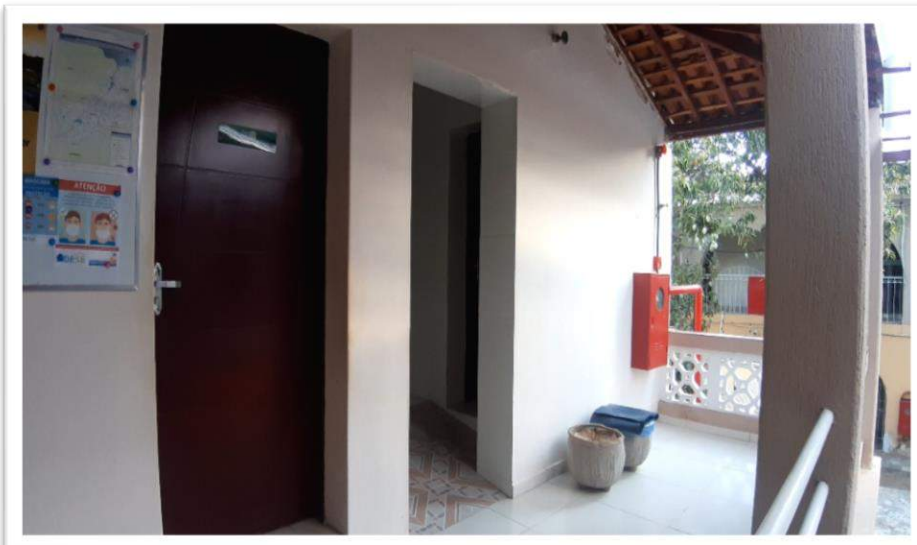
Foto 4: Sistema contra incêndio, acesso aos banheiros masculino e feminino e copa.
