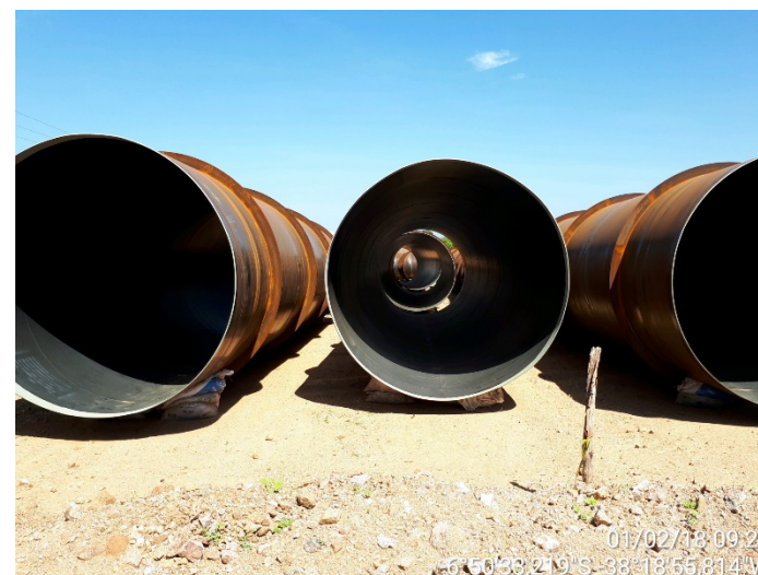
Tubulação (DN 2600mm) da TMDS
