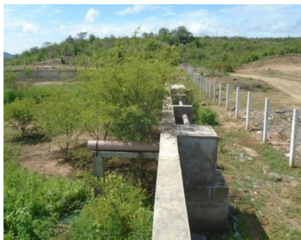
Entrada do esgoto na Lagoa Facultativa
