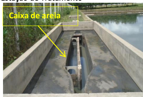
Vista geral da unidade de tratamento preliminar
