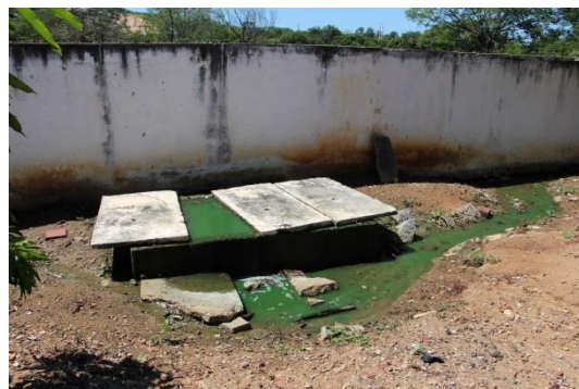
Efluente tratado (obstrução da tubulação de saída com retorno do efluente para a ETE)
