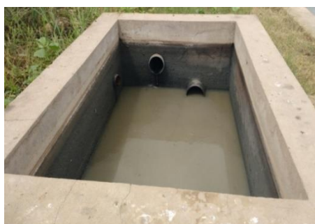
Caixa receptora do esgoto de vários pontos da cidade
