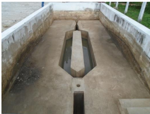
Vista geral da unidade de tratamento preliminar
