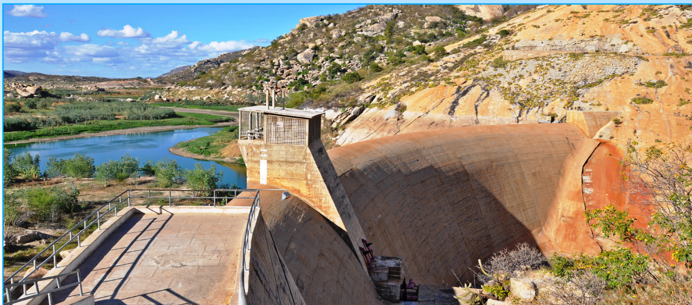
Parede do açude Gargalheiras, na região do Seridó, na qual foram apontadas falhas pelos técnicos - Foto Assecom CBH PPA
