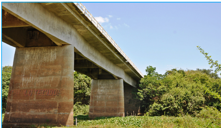
Ponte sobre o rio Piranhas, no município de Pombal/PB, local que também deve ser limpo
